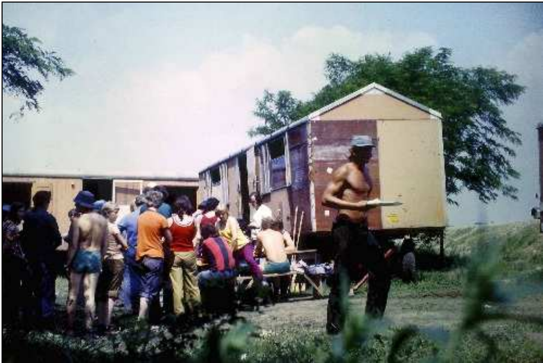
Verpflegungspause: Vor dem Bauwagen neben der Straßenbaustelle täglich das übliche Bild zur Mittagspause - geordnet anstehen! Niemand kam zu spät.
