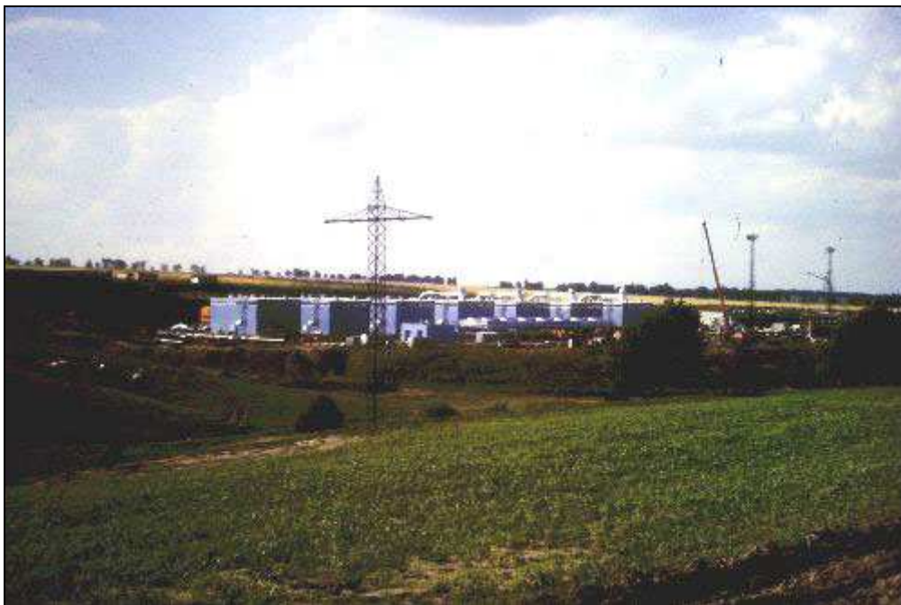
Westlich von Gaisin errichteten deutsche Spezialisten diese Gasverdichterstation. Alle 100 Kilometer wurden Verdichterstationen gebaut, die das Gas reinigen und 100 Kilometer bis zur nächsten Station pumpen.
